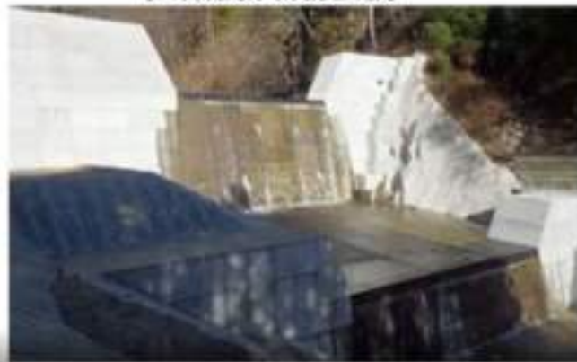
【土石流対策(砂防堰堤)】
